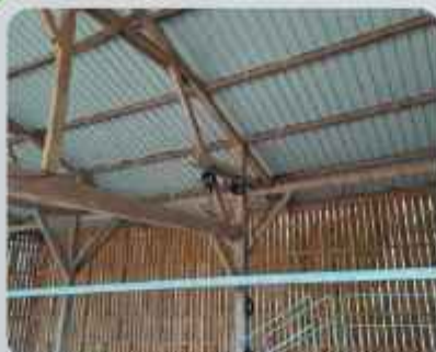
Éclairage et sono à la Halle.
