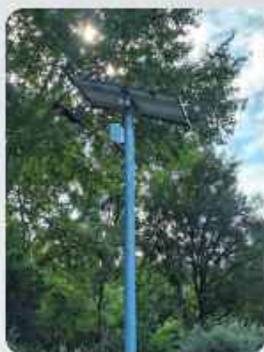
Mât d'éclairage public.
